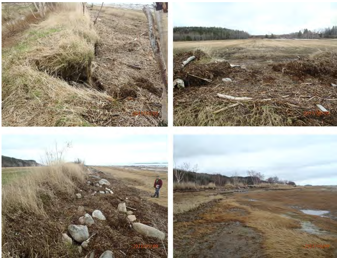
Figure 43. Photographies de l'état de l'aboteau réalisées en 2017 par la MRC de Kamouraska
