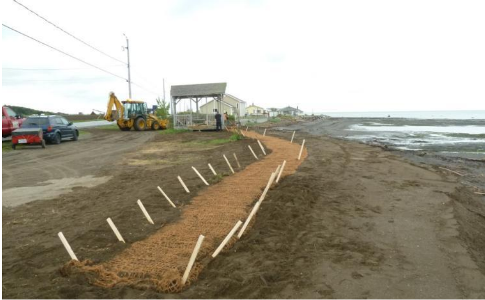
Figure 8. Installation d'un filet stabilisateur en fibre de coir, maintenue à l'aide de piquets de bois.
