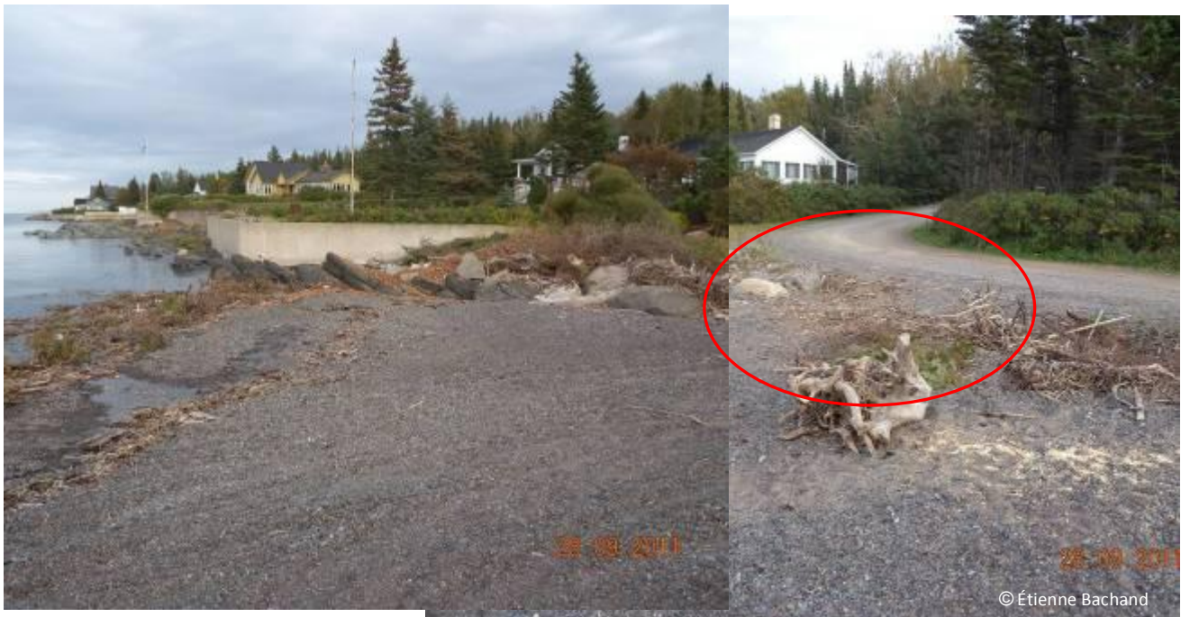
Figure 6. Effet de bout à l'extrémité de l'ouvrage de protection et de l'affleurement rocheux.
