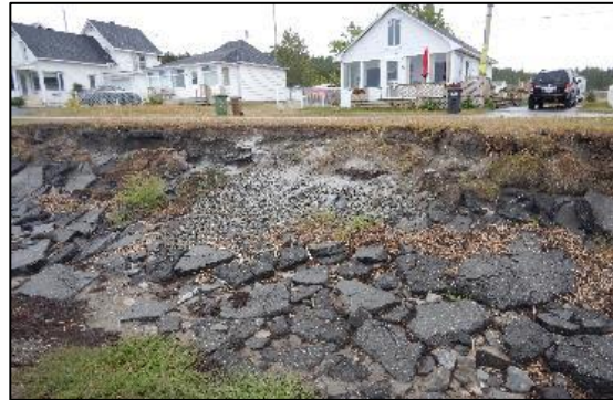
Figure 46. Morceaux d'asphalte provenant du remblai de la route à enlever du talus d'érosion.
