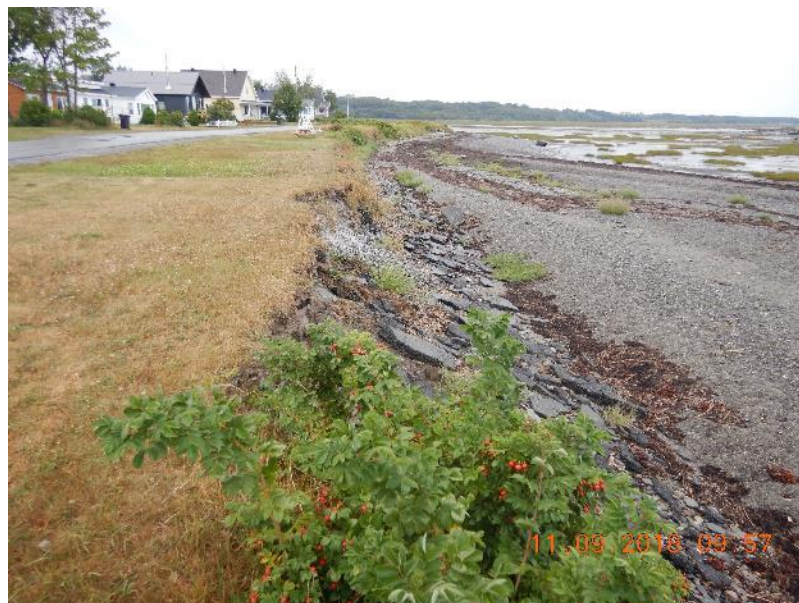
Figure 3. Érosion de la terrasse de plage et débris d'asphalte sur le talus.
