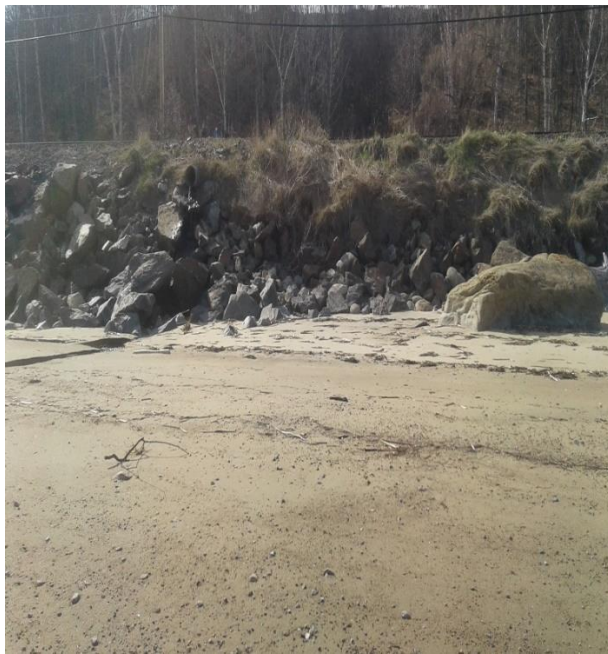
Figure 39 : Enrochement de la berge prévient l'érosion des berges ce qui peut nuire à la recharge de la plage
