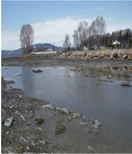
Figure 47 : L'enrochement et le mur de béton empêche tout apport de substrat propice à la fraie
