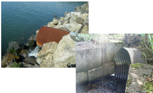
Tuyaux de rejet pluvial
