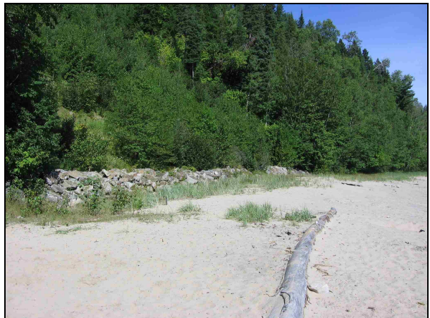
Photo 10 : Enrochement près des départs en kayak de mer
