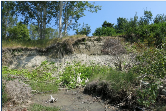
Décrochement de talus
