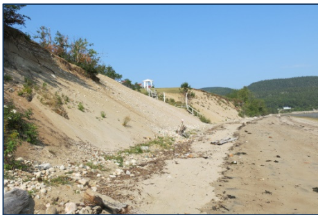
Décrochement de talus dans la section gazonnée
