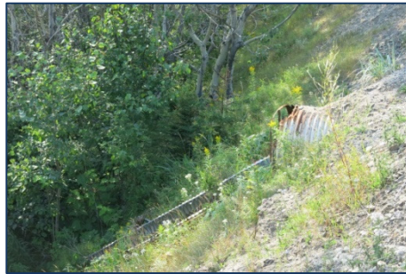
Vieux ponceau rouillé
