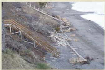
Ouvrages de protection contre l'érosion, caps de Maria, 2005
