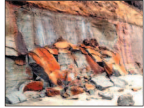
Décrochement d'une paroi rocheuse
