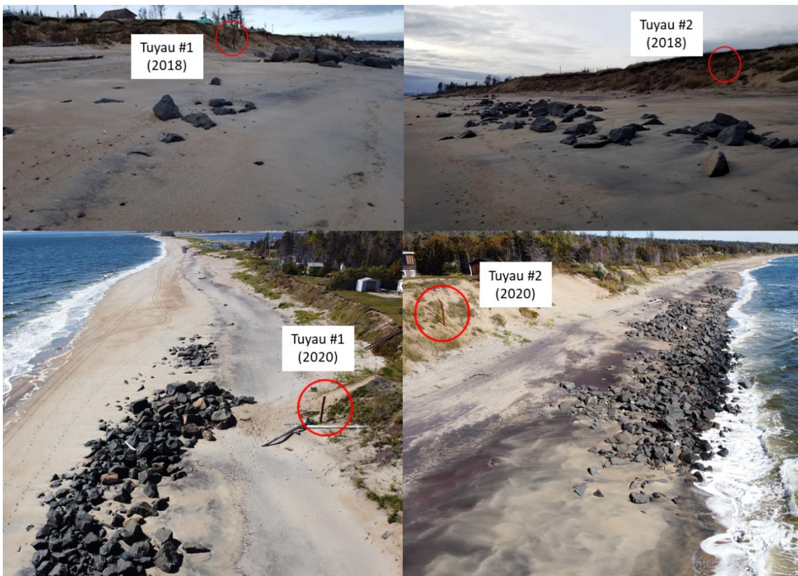
Figure 10. État du talus en 2018 et 2020
