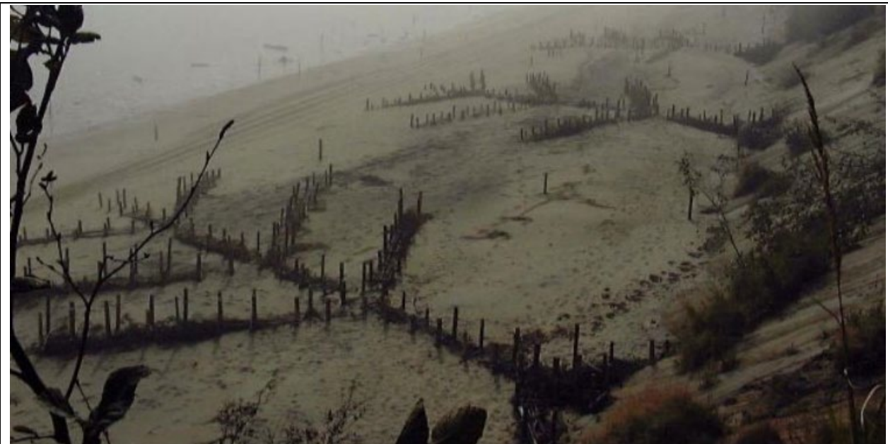
Photo 19. Épis SEMS réalisés pour contrer l’effet de bout d’enrochement à Pointe-aux-Outardes, 2000 (Comité ZIP de la rive nord de l’estuaire).
