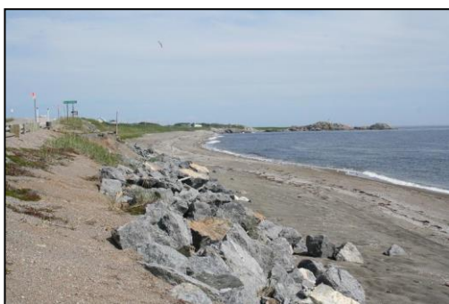
Figure 4.5. Structure d'enrochement sur la face Sud de la flèche littorale. Crédit photo : V. Provost.
